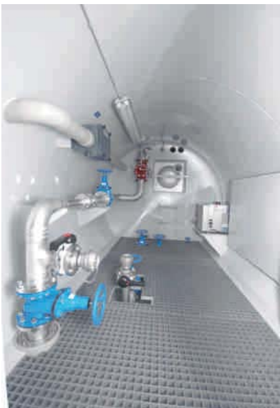
Reservoir mit montierten Leitungen aus Chromstahlrohren.
